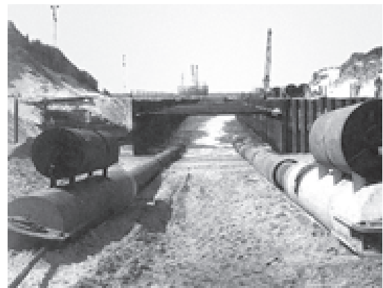
Naturgasledningerne bliver ført i land ved den jyske vestkyst.
